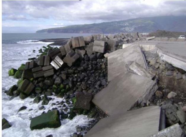
Erosion côtière – POINTE DES GALETS (Gamède, 2007)
