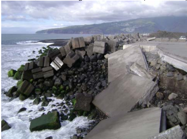
Erosion côtière – POINTE DES GALETS (Gamède, 2007)
