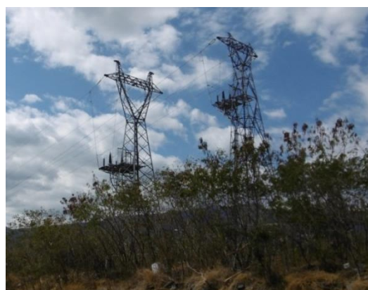
Figure 23 : Pylônes électriques à proximité de l'entrée du centre pénitentiaire
